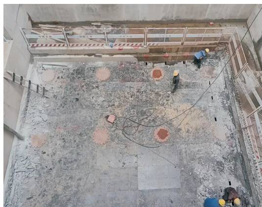
图8 钢管柱顶面高出中板模板
