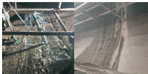
图 8 孔口涌水、衬砌跑冒浆处理
