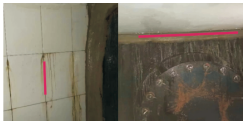
图 1 蜗壳进人门右侧墙面、顶板交界渗水情况
