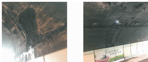
图 2 隧道渗水、衬砌剥落缺陷近照
