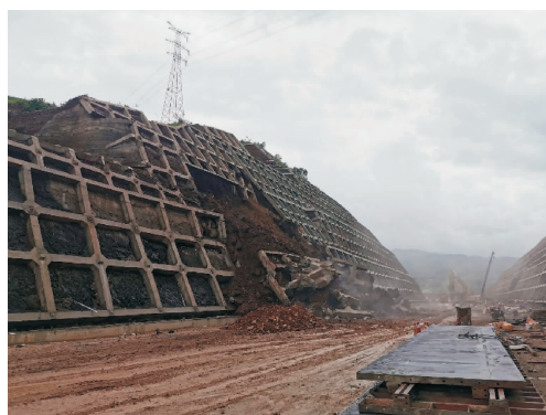
图6 失稳路堑边坡概貌
