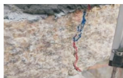
(b) 板侧裂缝
