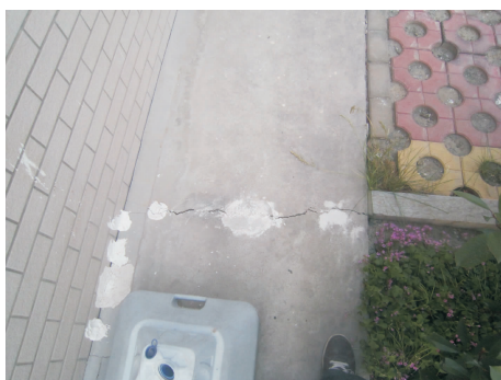
图 2 双排桩与桩锚支护连接处距坡顶一定距离处的 A 点裂缝图
