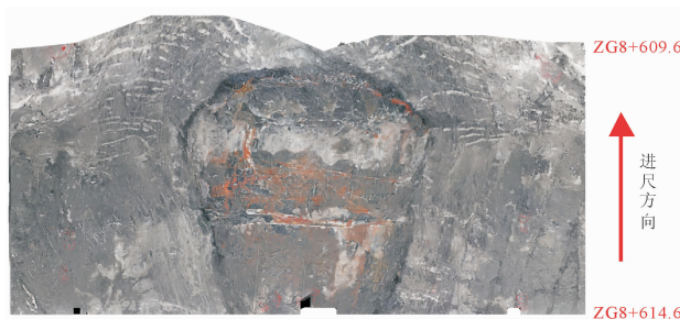
图 13 大山岭隧洞 ZG8 + 614.6—ZG8 + 609.6 段洞壁展开图
