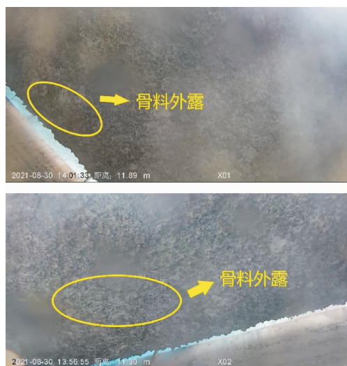
图 3 粗格栅内部混凝土结构腐蚀情况
