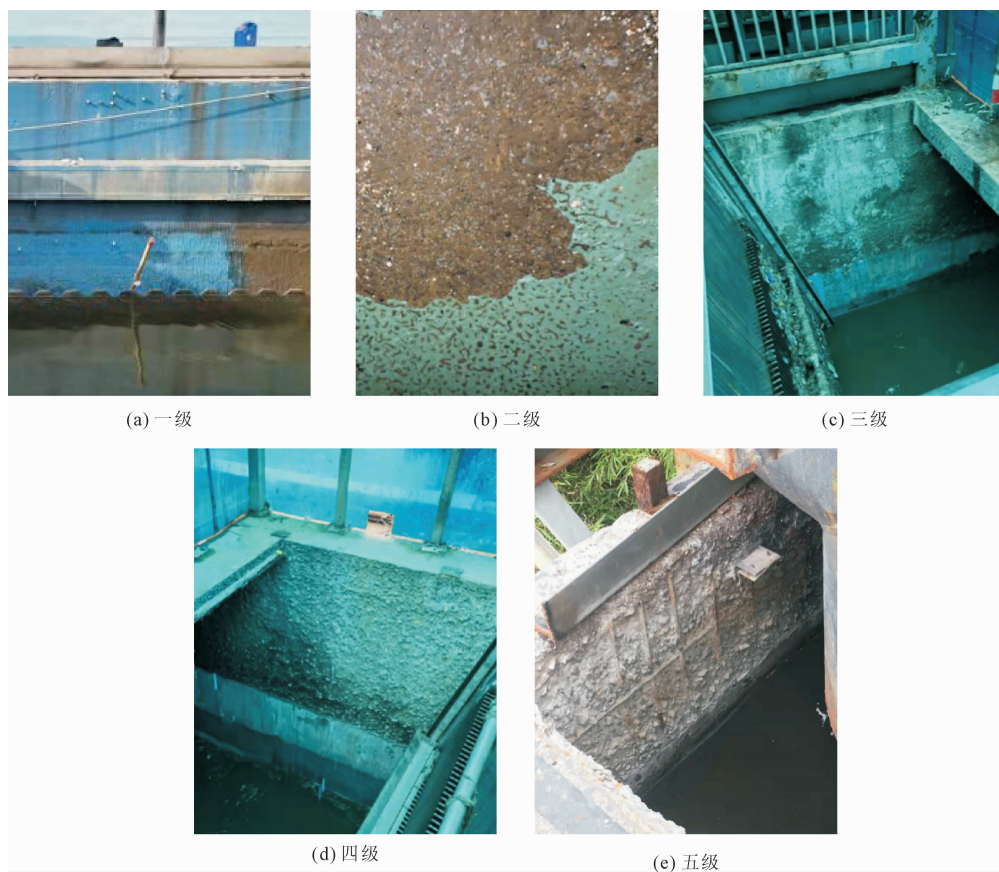
图 1 不同技术状况混凝土构筑物外观
