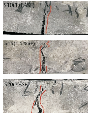
图 6 不同纤维掺量的 UHPC 纯弯段裂缝形态
