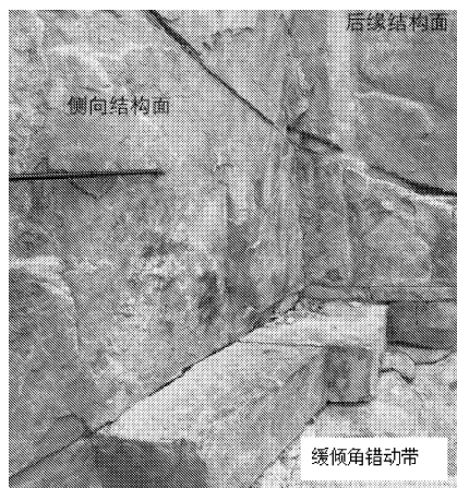
图 3 结构面产生滑移、拉裂破坏后的形态
