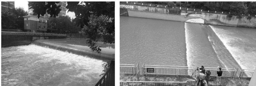
图1 成都市府南河万福桥橡胶坝现状
