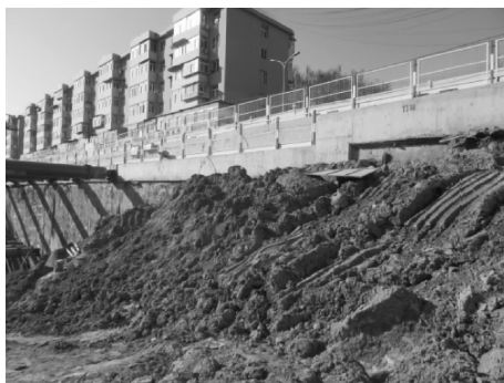
图 6 第一道支撑缺失情况
