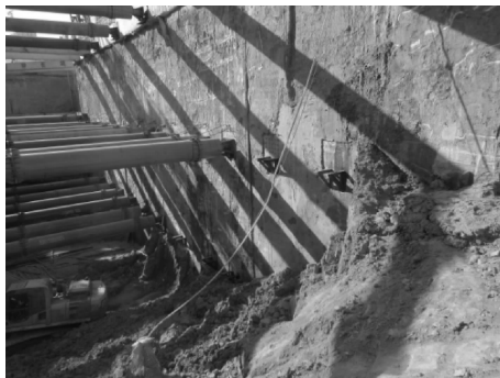
图 7 下两道支撑缺失情况
