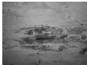
图 5 空箱顶板底面钢筋局部锈蚀外露
