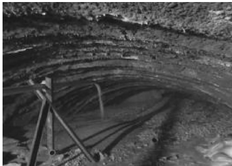
图1 施工围岩变形过大
