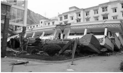
图 1 某中学框架教学楼整体倒塌
