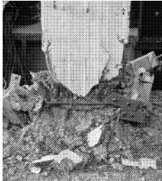
(b) 底层中柱柱脚混凝土压溃
