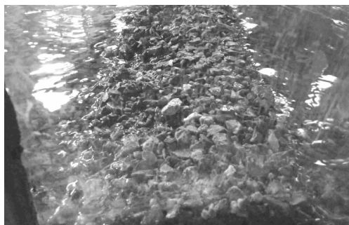
图8 坝顶块石滑落至背水坡
