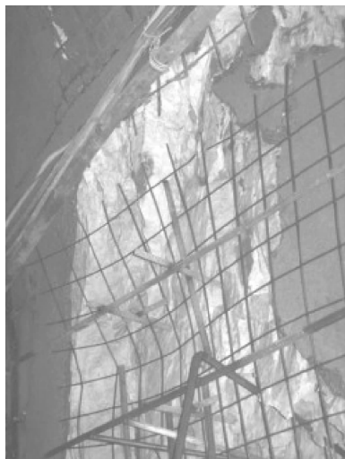
图 1 拉张型板裂化岩爆坑
