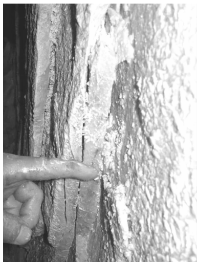
图 2 拉张型板裂化片帮坑
