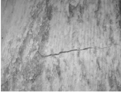
图 4 洞壁水平张裂缝
