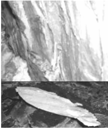
图 5 锦屏二级水电站实验支洞 C 中的楔形板状破坏
