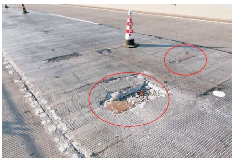
图3 混凝土桥面铺装破损
