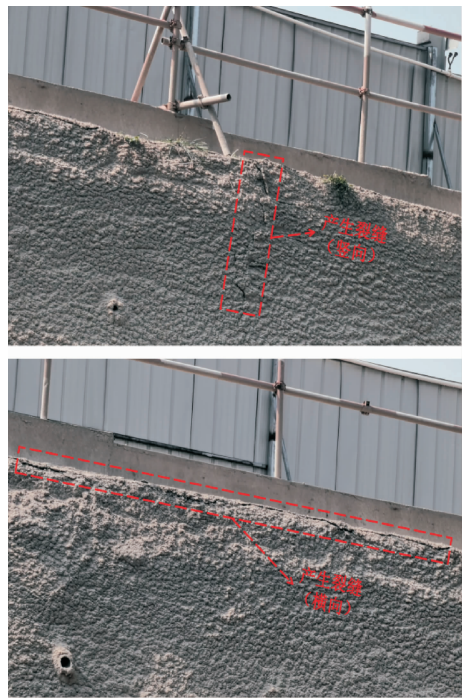
图 10 现场沉降产生裂缝示意图
