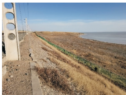
图1 青藏铁路K222+500区段青海湖距青藏铁路现状图
