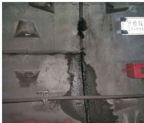
图1 盾构管片渗水
