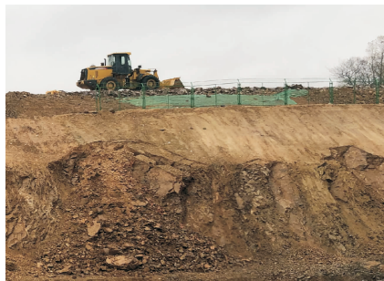
图 2 LTK2 + 650 处边坡失稳
