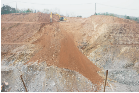
图 11 LTK3 + 150 处边坡失稳照片
