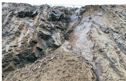
图 7 LTK2 + 720 处边坡失稳照片
