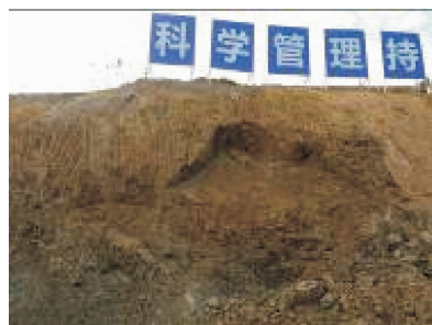
图 5 LTK2 + 835 处边坡失稳照片
