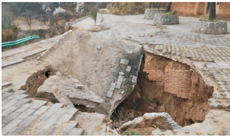
图 3 X1 斜坡坡顶塌陷形成落水洞
