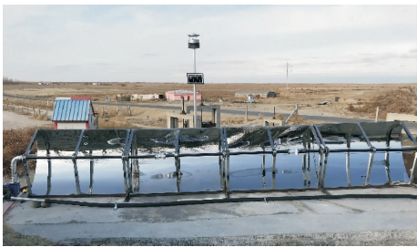
图 8 渠岸光热蓄集系统现场照片
