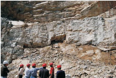
(b) 倾外结构面控制的右岸边坡变形破坏
