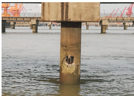
图 1 排架受撞桩基混凝土破损
