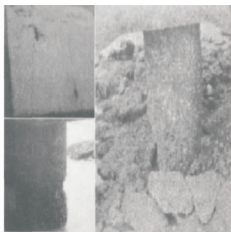
图 3 灵昆大桥腐蚀图片
