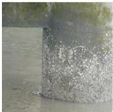
图 6 下白石特大桥墩柱腐蚀图
