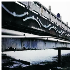
图 2 海燕大桥腐蚀图片
