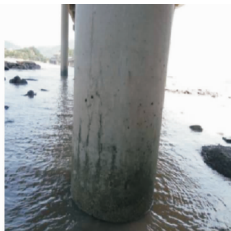
图 7 杨家溪特大桥墩柱腐蚀图
