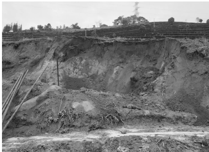
图 5 K31 + 565.5 地表塌陷坑
