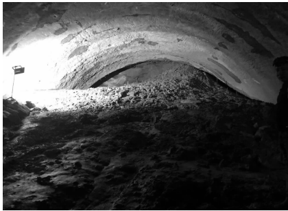
图 4 宾房 2 号隧道右幅 K31 + 565.5 隧道坍塌状况
