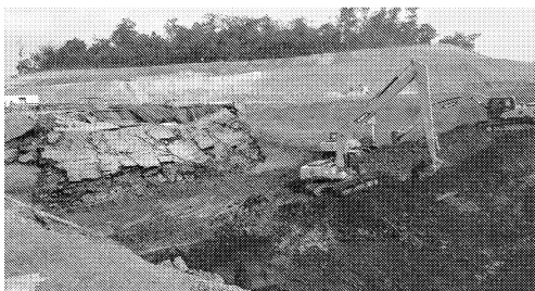
(b) 煤层切穿造成的基坑边坡破坏现象
