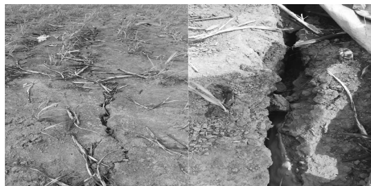
图 2 坡顶裂缝现状
