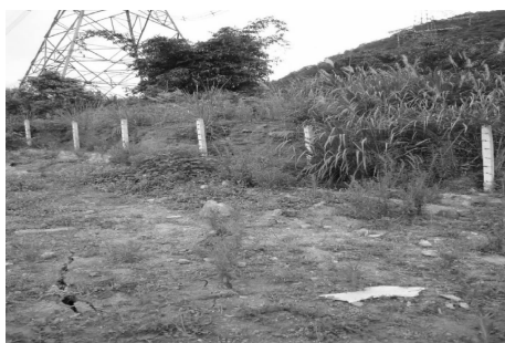
图4 1#塔基周围的拉张裂缝
