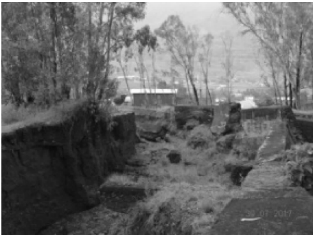
图 5 已倒塌的防水墙
