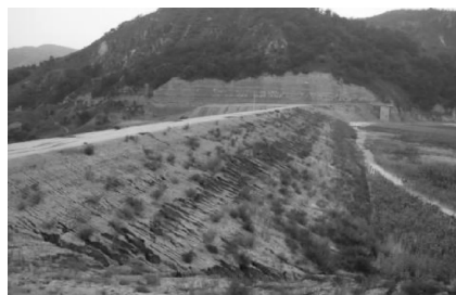
图 2 龙泉寺水库坝料场坝坡冲蚀情况
