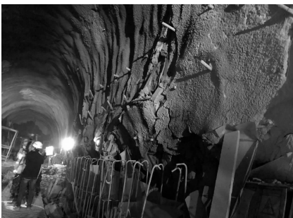
图 5 边墙拱架外鼓、喷射混凝土纵向开裂
