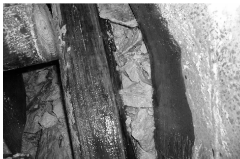
(a) 掌子面塌方
