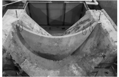
图 15 坝体上游面破坏情况
