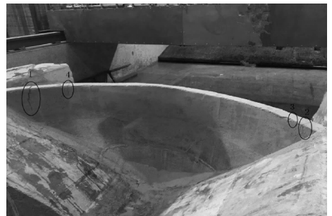
图 16 坝体下游面破坏情况
