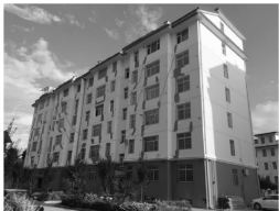
图 7 楼房反八字裂缝
