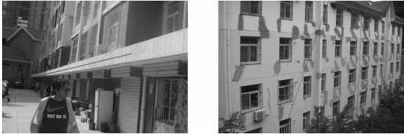
图 10 横梁弯曲 图 11 楼房正八字裂缝
