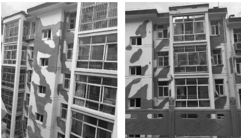
图 3 楼房单斜裂缝
