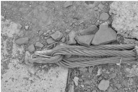
图 5 锚杆外露套环破坏
