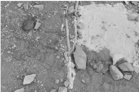
图 7 钢丝绳卡扣锈蚀
