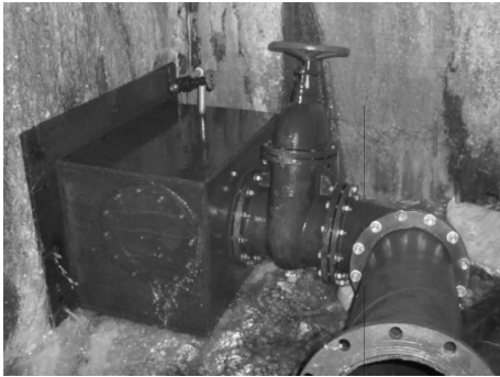
图 3 止水灌浆盒实物图
